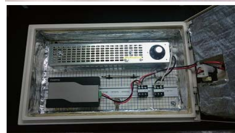
＜冷凍環境用UHFリーダの内部＞
